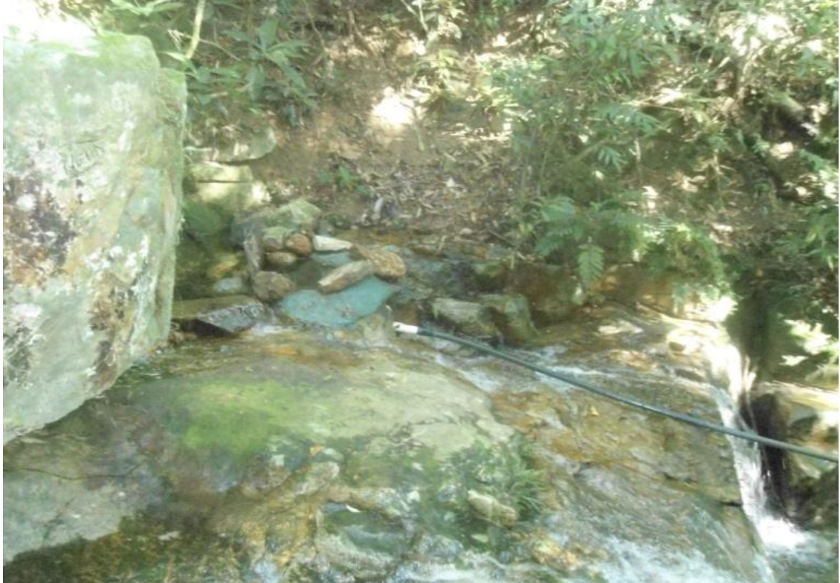
Figura XI - Tubulação que capta a água das nascentes para a caixa distribuidora (Foto Júlio Vitor)
