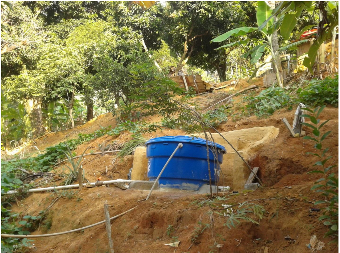
Figura XVII - Caixa d'água de armazenamento da captação da água da nascente, localizada no quintal do Seu Joaquim (Foto Lucas Neves).
