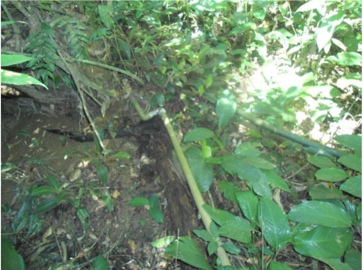
Figura X - Parte da tubulação que leva água da nascente pela a mata. (Foto Júlio Vitor)
