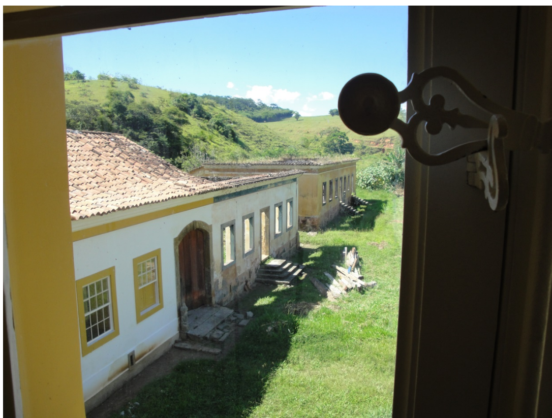
FIGURA 33: Vista superior da casa do administrador e do hospital, ambas com integridade bastante comprometida pelo tempo. Foto: Luiz Fernando Dutra Folly.
