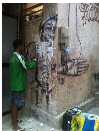
Figura 27 A Casa-Tela 03 estava bem degradada antes da restauração.
