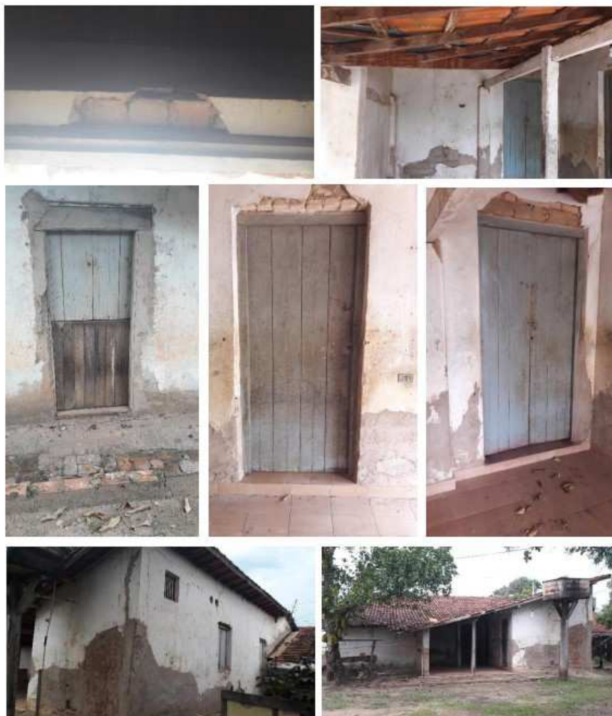
Paredes com deslocamento de revestimento
