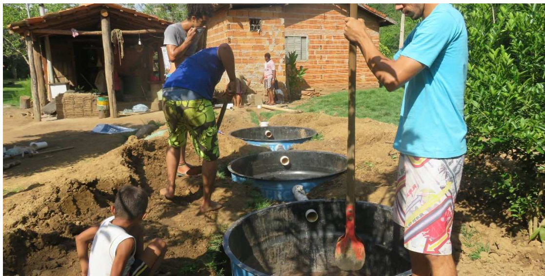
Figura 35 – Instalação do sistema de tratamento de efluentes em casa na comunidade Morro Redondo
