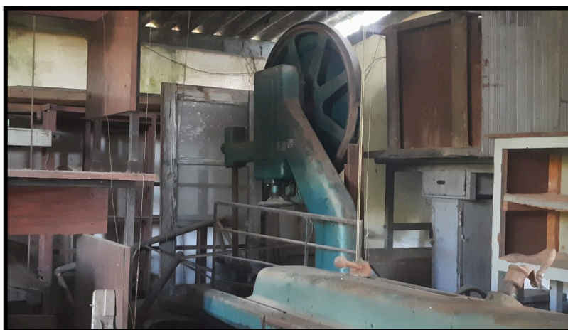
Figura 54 - Serra de fita abandonada e inacessível
