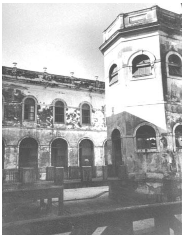
Figura 58 - Hospício Nacional de Alienados - Degradação do prédio
